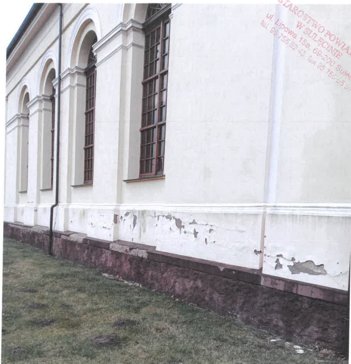
Fot. 6. Widok elewacji od strony północno-zachodniej. Widoczne uszkodzenia tynku spowodowane wilgocią na wskutek występującego w ścianach transportu kapilarnego wody z cokołu
