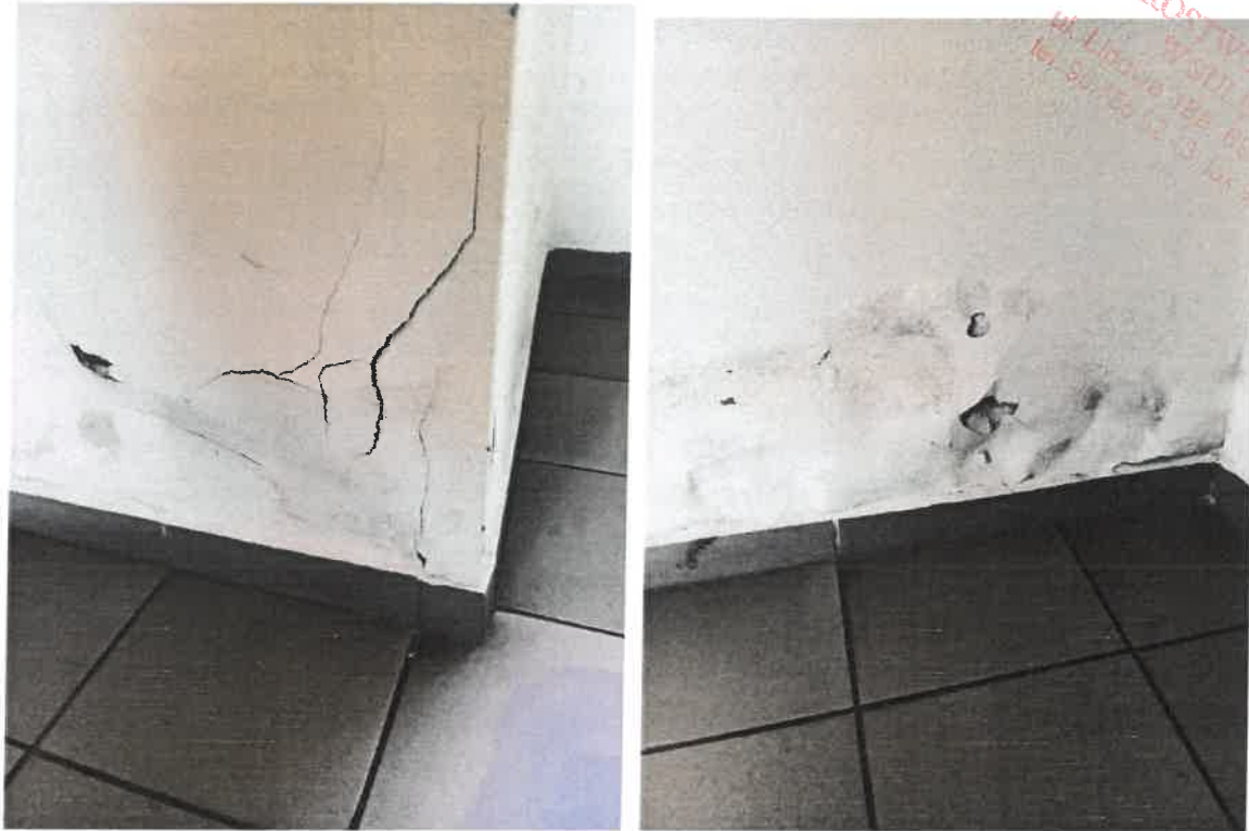
Fot. 7, 8. Wnętrze kościoła - widoczne uszkodzenia tynków spowodowane wskutek występującego w ścianach transportu kapilarnego wody z cokołu
