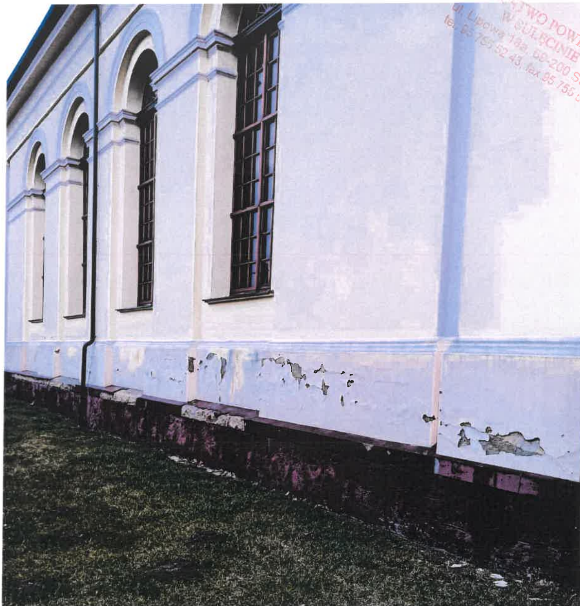
Fot. 6. Widok elewacji od strony północno-zachodniej. Widoczne uszkodzenia tynku spowodowane wilgocią na skutek występującego w ścianach transportu kapilarnego wody z cokołu
