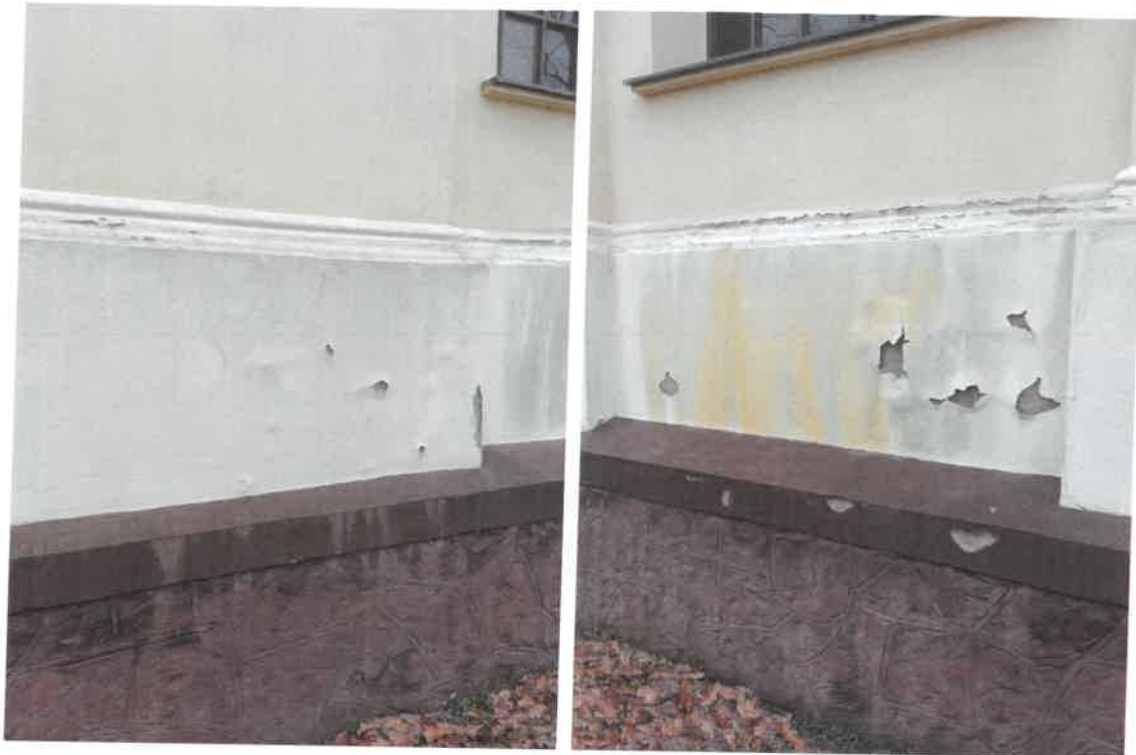
Fot. 4. Widoczne uszkodzenia tynku na elewacji spowodowane niszczącym działaniem wody, wiatru i mrozu oraz na wskutek występującego w ścianach transportu kapilarnego wody z cokołu
