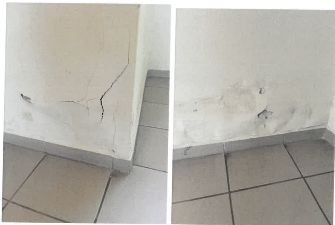
Fot. 7, 8. Wnętrze kościoła - widoczne uszkodzenia tynków spowodowane wskutek występującego w ścianach transportu kapilarnego wody z cokołu
