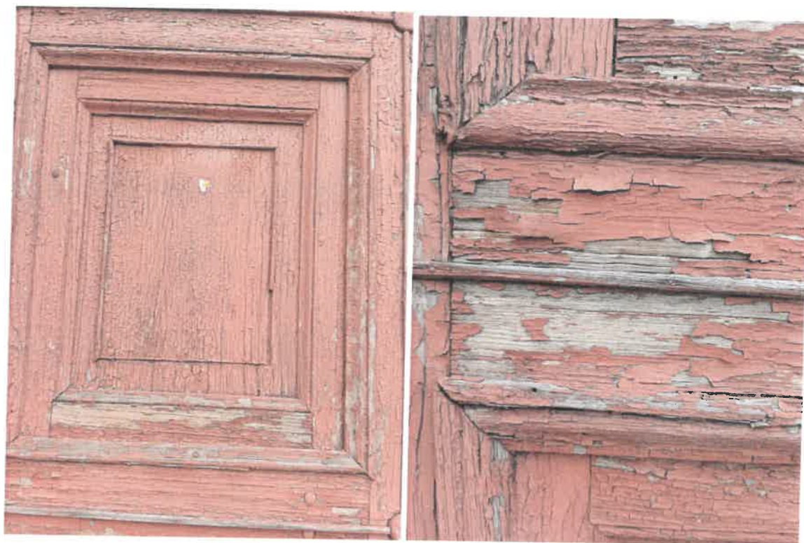
Fot. 10, 11. Widoczne wielokrotne nawarstwienia farb olejnych łuszczące się z ubytkami drewna
